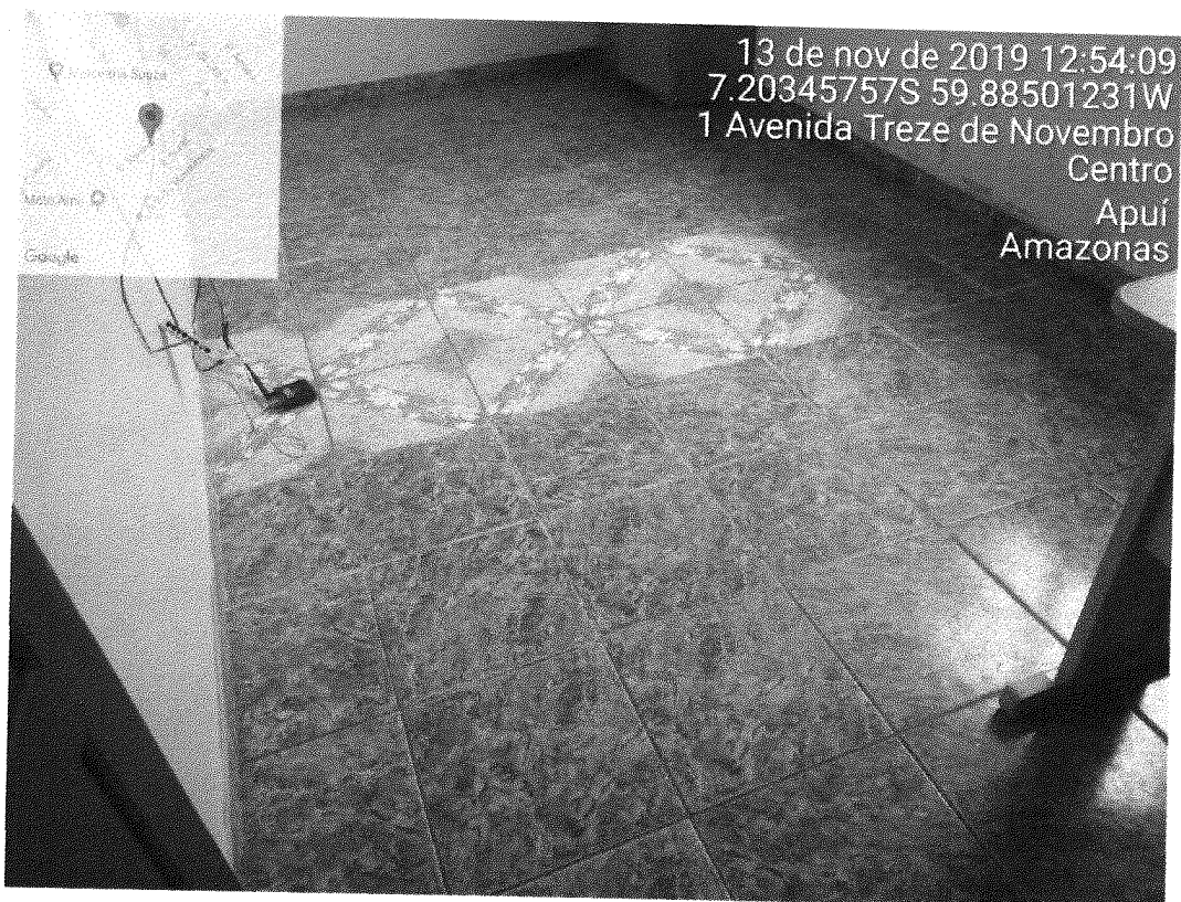
IMAGEM 15 - Afundamento (recalque) do piso do gabinete de assessoria parlamentar.
