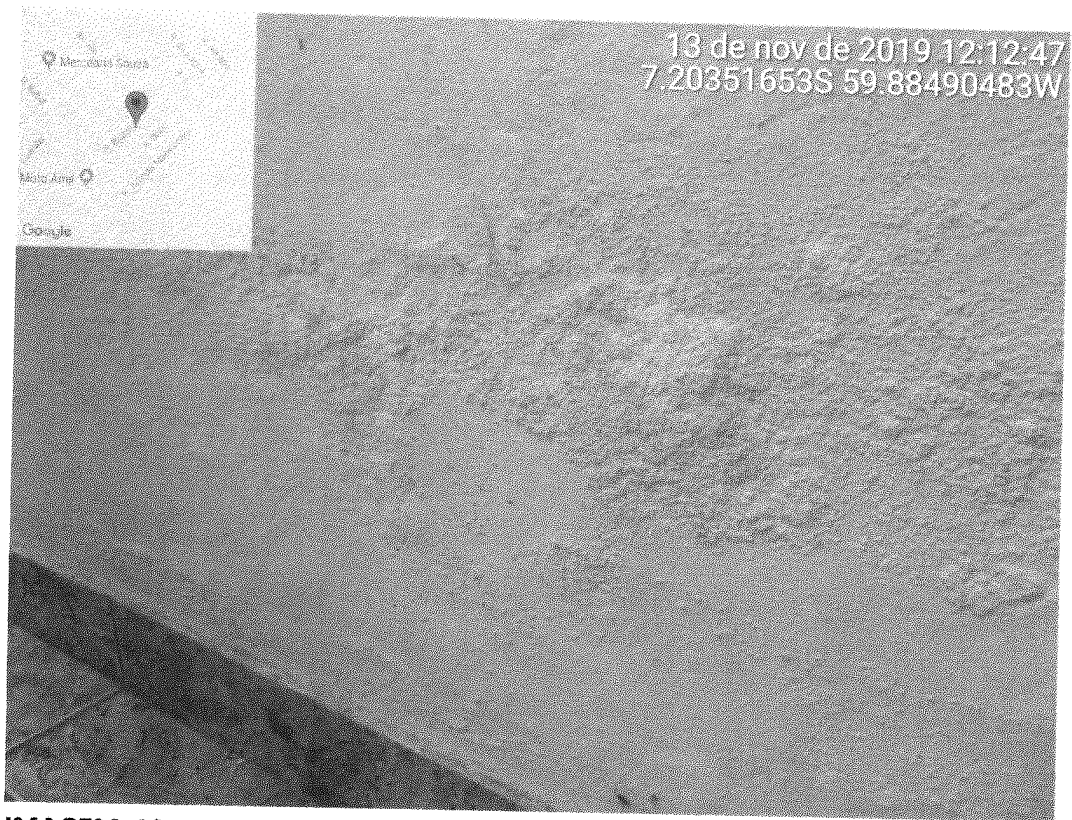
IMAGEM 12 - Degeração no revestimento de argamassa (REBOCO) e pintura interna/externa devido à contínua presença de umidade na base das paredes;
