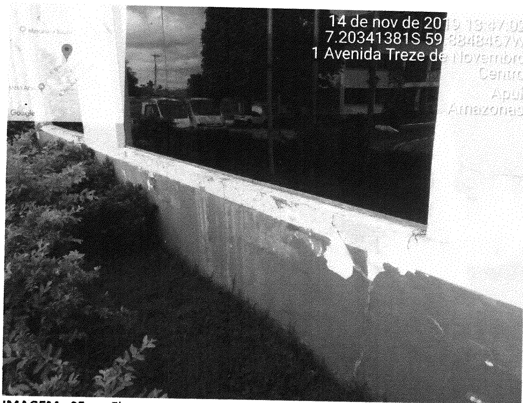
IMAGEM 05 - Elemento estrutural (FUNDAÇÃO) da parede frontal/plenária, encontra-se com recalque localizado devido a saturação do solo por penetração de água da chuva e absorção de água por vegetal localizada proxima a fundação.
