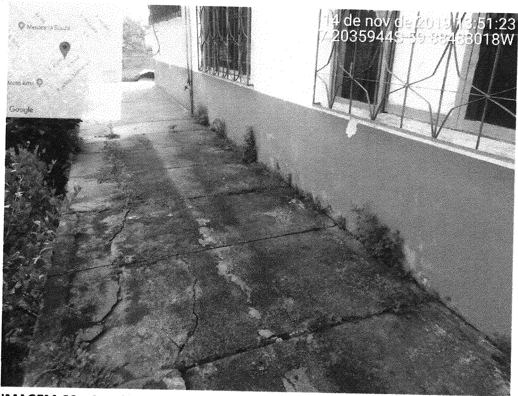
IMAGEM 08 - Deslocamento, fissura, trinca do contrapiso da calçada externa em torno do prédio pela ausência de junta de dilatação e dessolidarização;
