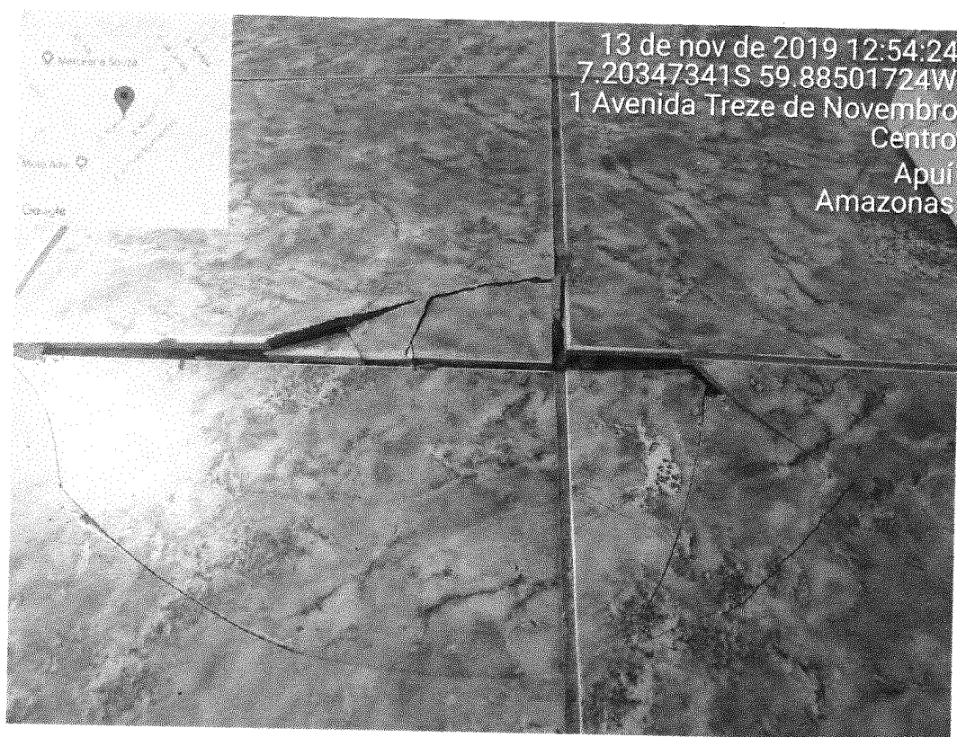
IMAGEM 14 - Afundamento (recalque) do piso do gabinete de assessoria parlamentar.
