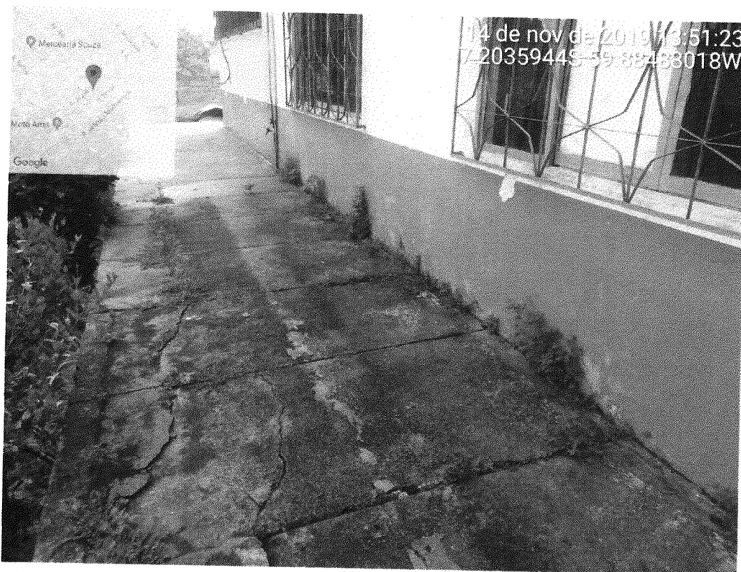
IMAGEM 08 - Desplacamento, fissura, trinca do contrapiso da calçada externa em torno do prédio pela ausência de junta de dilatação e dessolidarização;
