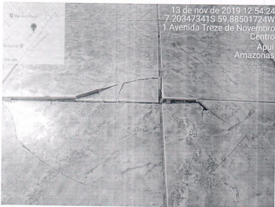
IMAGEM 14 - Afundamento (recalque) do piso do gabinete de assessoria parlamentar.
