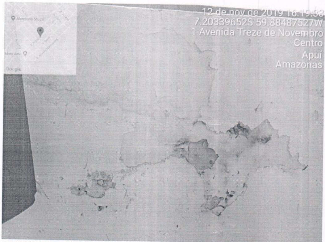
IMAGEM 02 - Infiltrações de água por capilaridade pela ausência do sistema de impermeabilização da fundação (VIGA BALDRAME);
