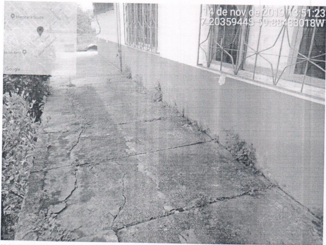
IMAGEM 08 - Deslocamento, fissura, trinca do contrapiso da calçada externa em torno do prédio pela ausência de junta de dilatação e dessolidarização;
